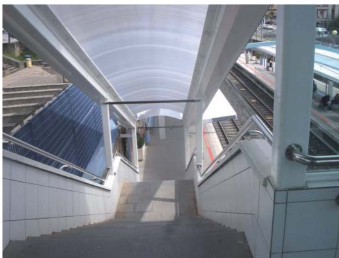
Eguraldiaz babesteko estaldura, Larrabasterrako geltokian. Cobertura contra las inclemencias en la estación de Larrabasterra.
