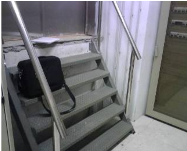
← Vista de las escaleras de acceso al cuarto antes de su mejora
