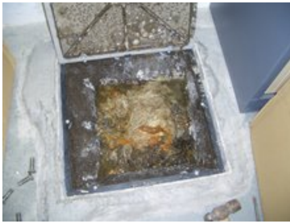
← Estado de la instalación antes de la limpieza
