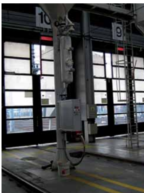
Sistema de transporte y aspiración de carga de arena Taller de Ariz
