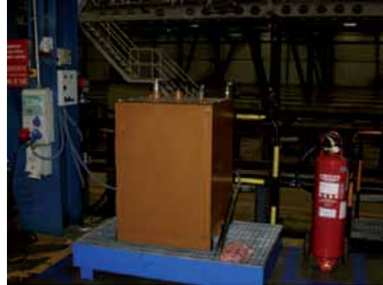
Sistema de carga de aceite reductoras UT's en área técnica Sopelana
