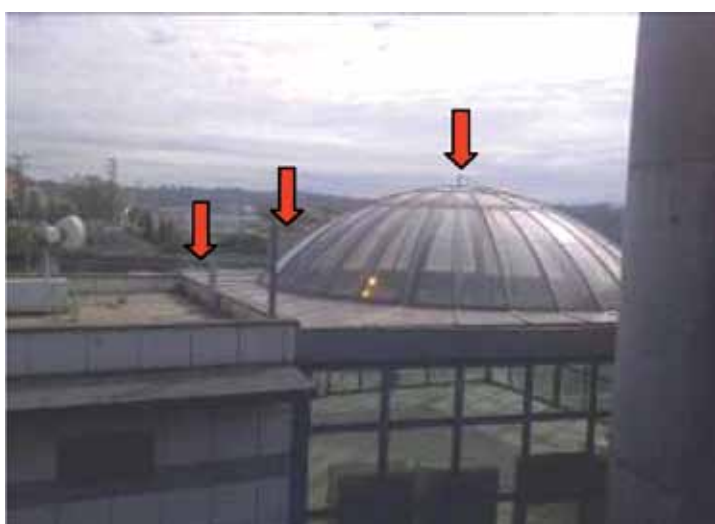
Líneas de vida instaladas
