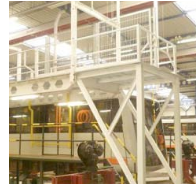
Ampliación de la plataforma de acceso a techo UTs en vías 8 y 9 en el área técnica de Sopela.
